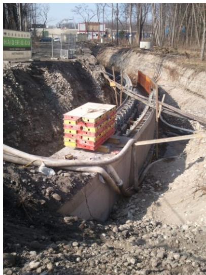
Zulauf HSEK – Kläranlage
