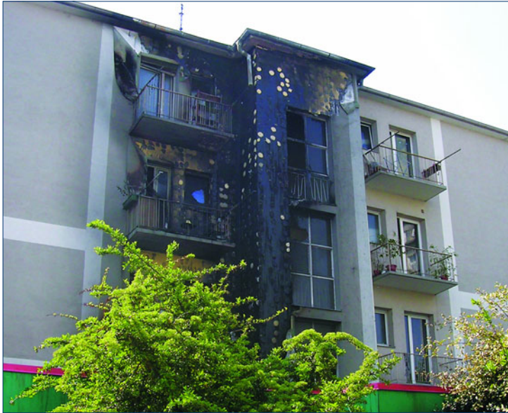
Eine Zigarette landet „irrtümlich“ im Papiercontainer. Die Auswirkungen – siehe rauchgeschwärzte Fassade – müssen nicht näher erläutert werden!
